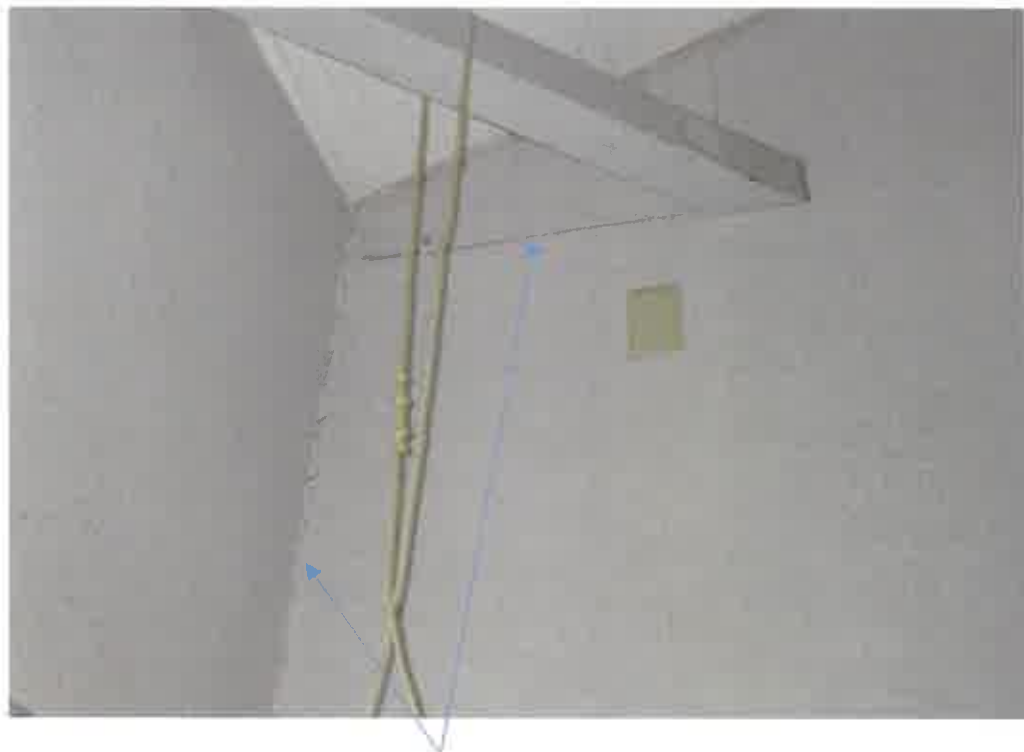
物件2:2階東側洋室の内壁のひび等
