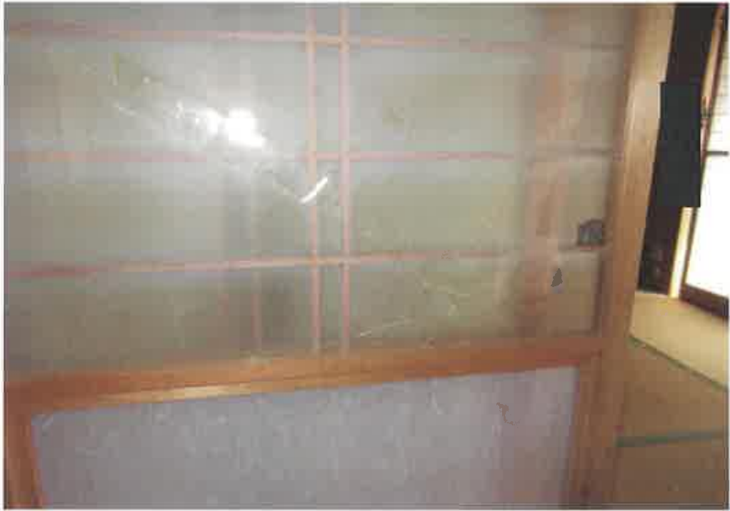
物件2:1階リビング脇和室の引き戸のガラス部分の破損状況
