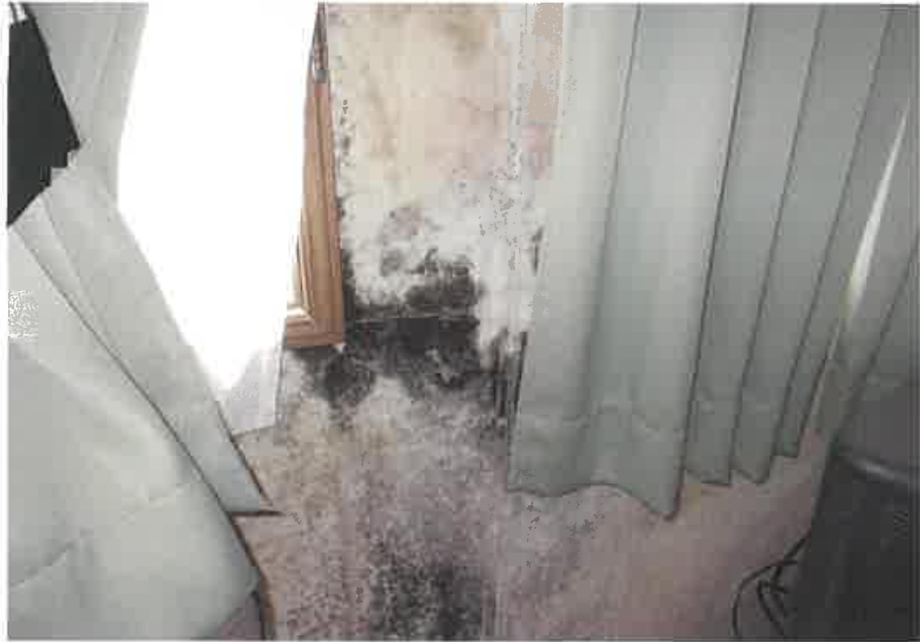
物件2:1階リビングの西側の内壁クロス の汚損等の状況
