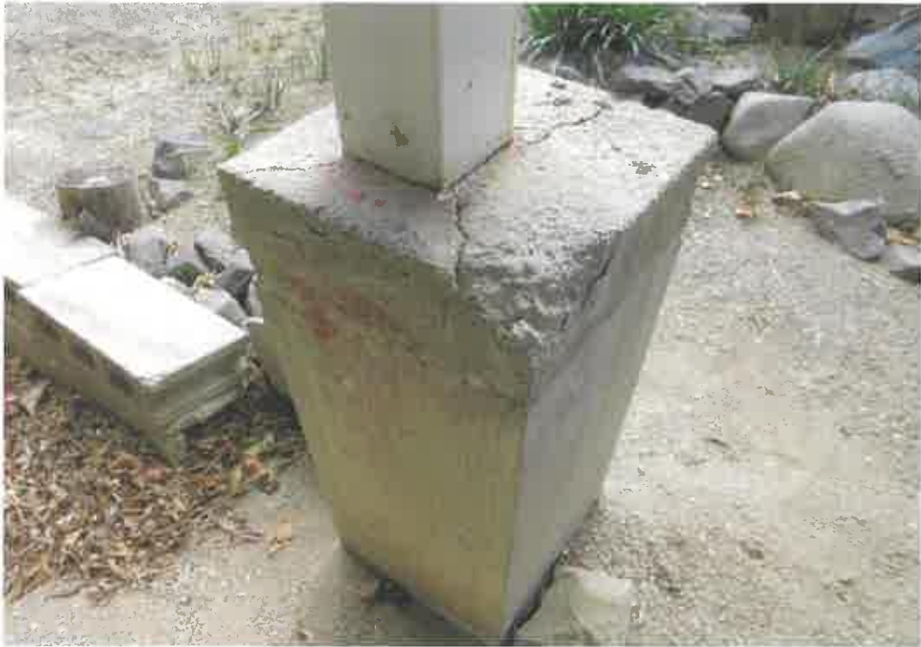
物件2:鉄骨支柱土台のコンクリートの亀裂等の状況
