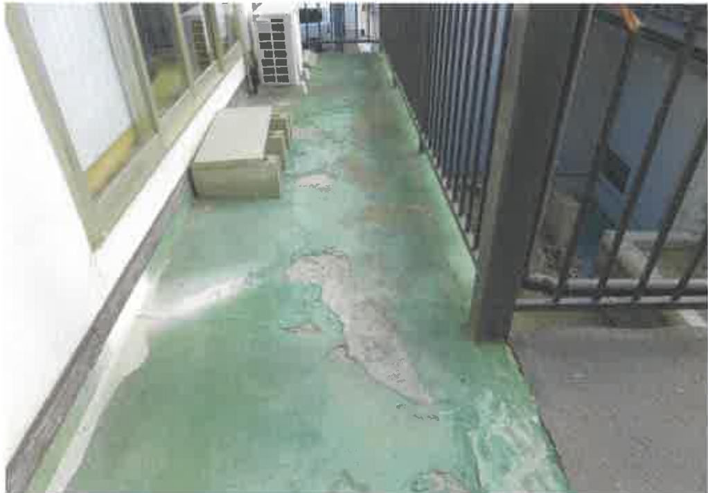
物件2:1階ベランダの防水シートの剥離等の状況
