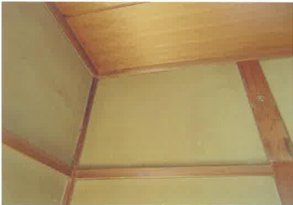
物件2:2階和室の砂壁の汚損や天井の廻り縁との間の隙間等の状況
