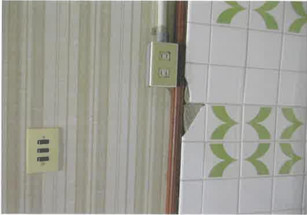
物件2:1階台所のタイルの損傷の状況
