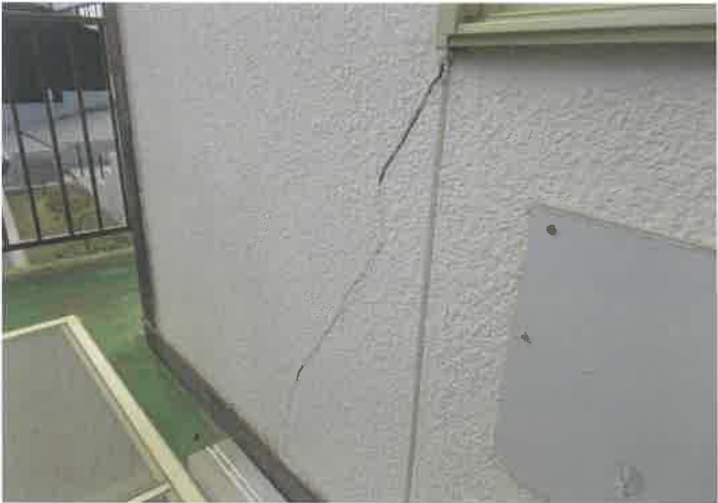
物件2:外壁のひびの状況
