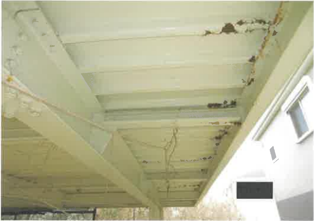
物件2:鉄骨造鉄板敷の基礎部分の錆の状況
