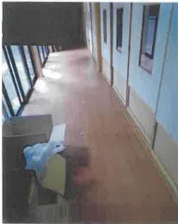
物件2:広縁部分の床の褪色の状況
