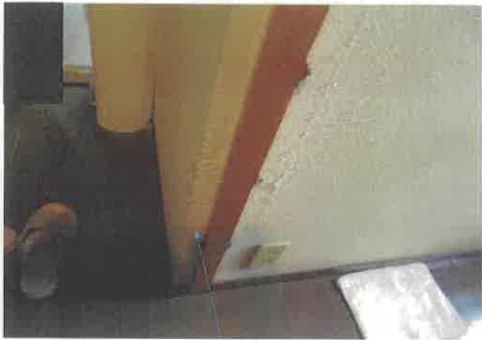
物件3主である建物:2階廊下の内壁の猫の爪とぎ跡
