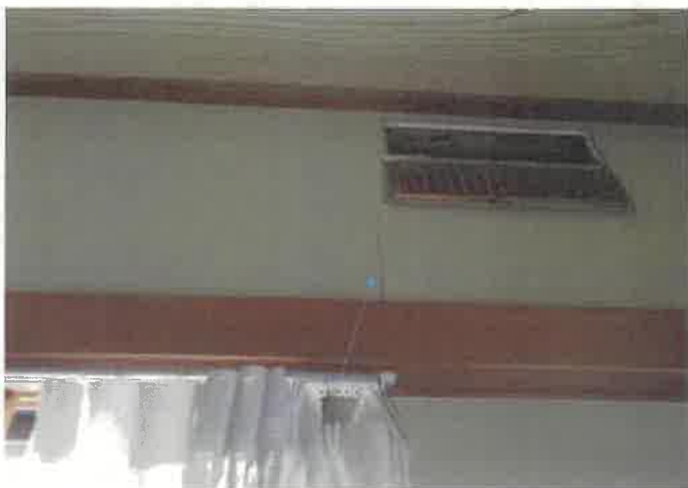
物件3主である建物:1階板の間のある和室 の内壁のひび
