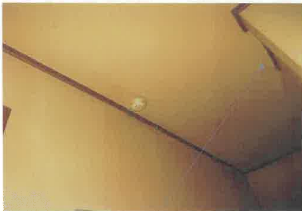
物件3主である建物:1階ホールの天井クロスの剥 がれ
