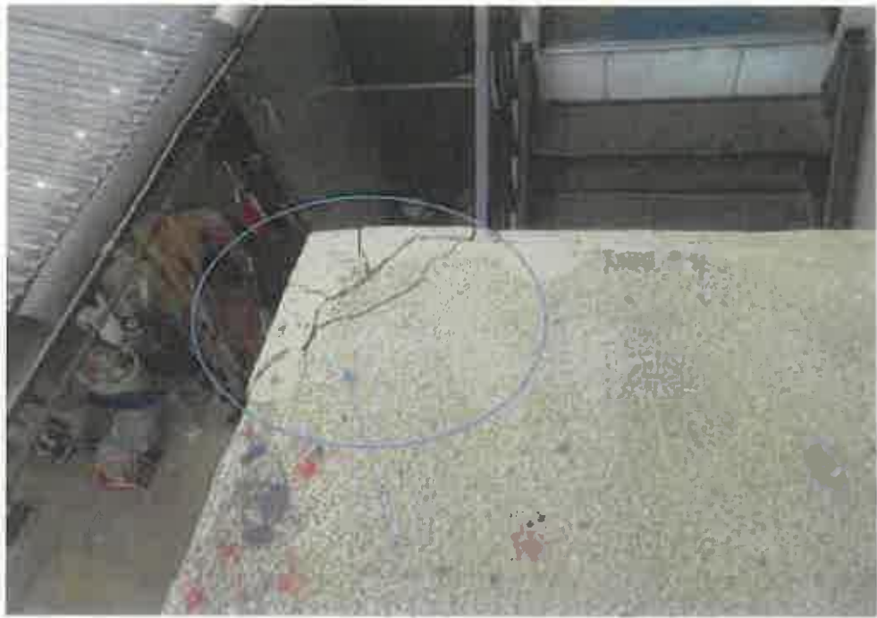
物件2:2階物置の階段設置部分のコン クリートのひび
