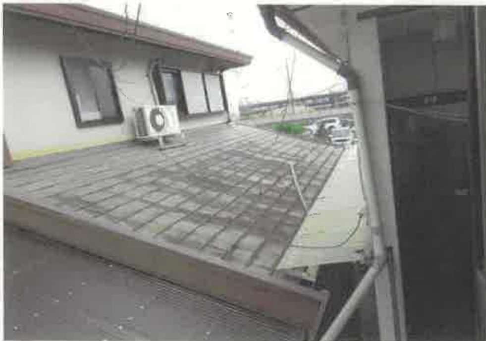
物件3主である建物の北側の屋根の汚損の状況
