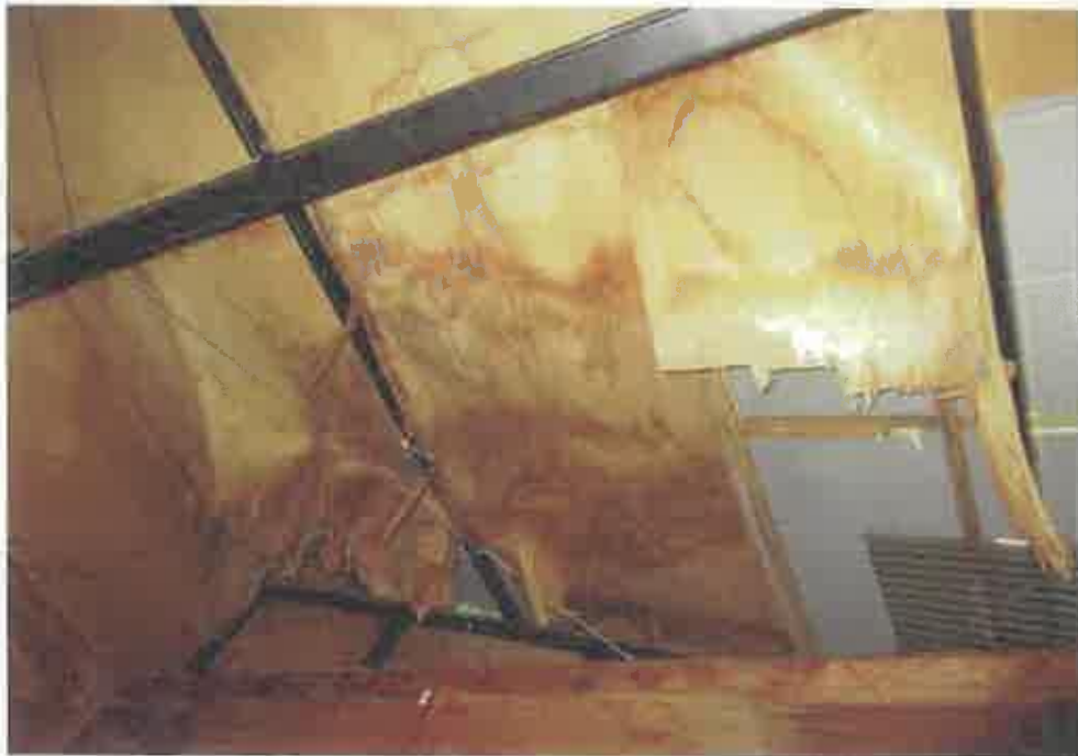
物件3附属建物:2階天井の腐食等の状況
