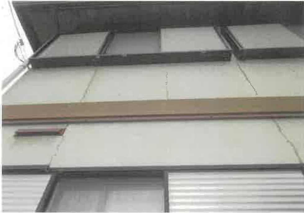
物件3主である建物の外壁のひびの状況
