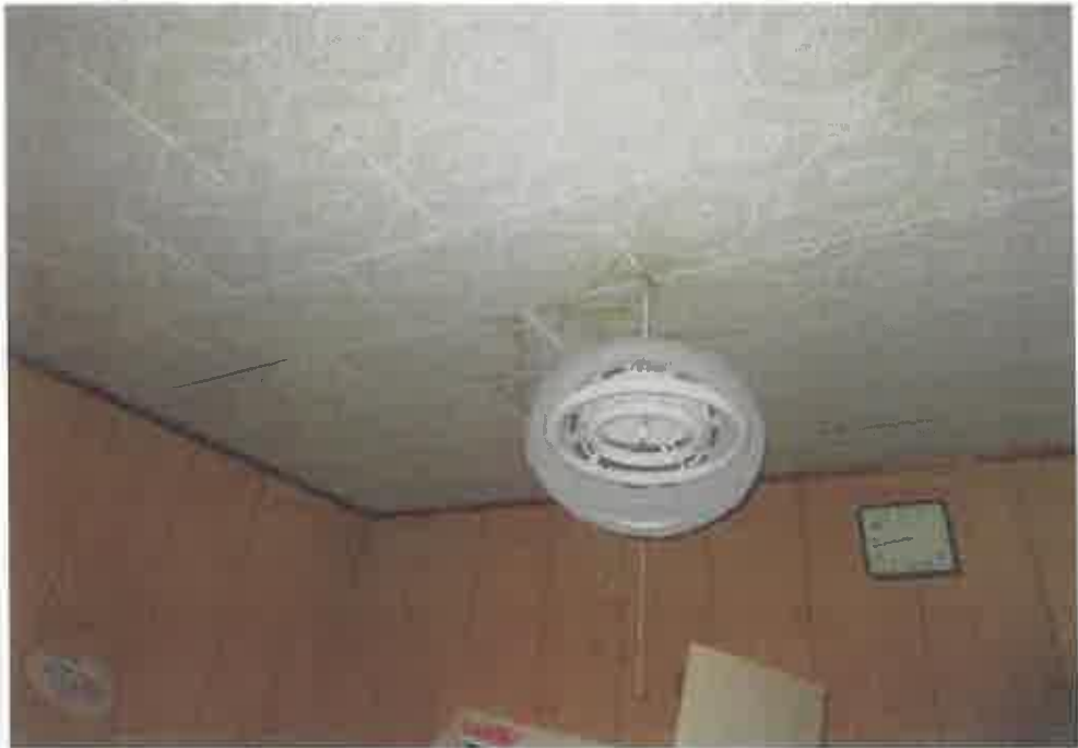
物件2:2階物置部分の天井のしみ等の状況
