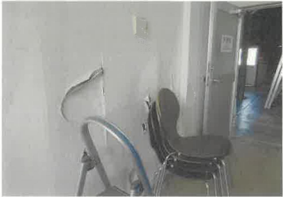
内壁の損傷等の状況
