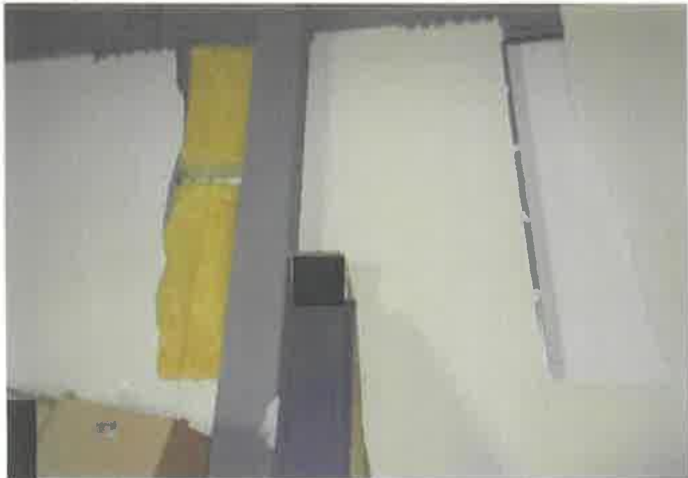
内壁の損傷等の状況
