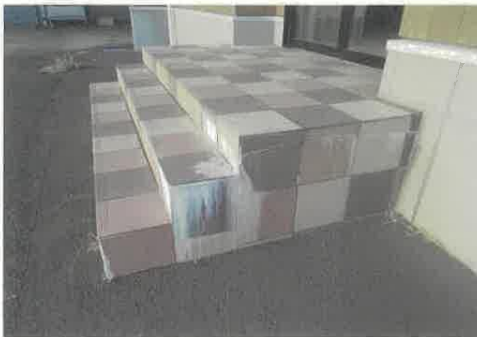
物件1附属建物符号2の玄関ポーチの階段部分側面等のひびの状況
