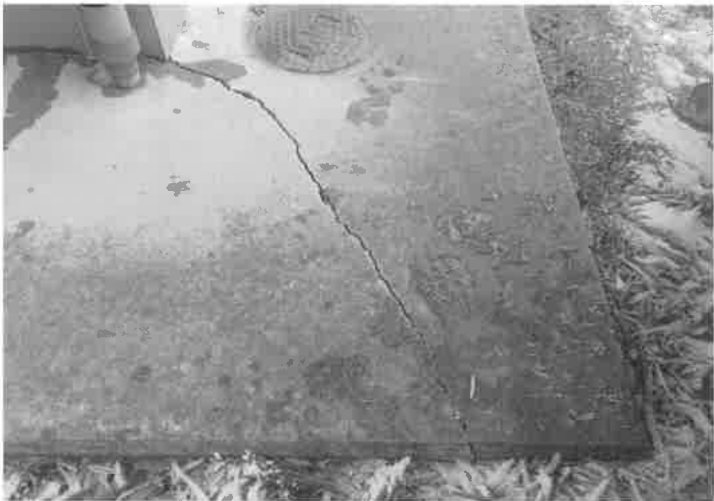
物件1:犬走り部分のひびの状況
