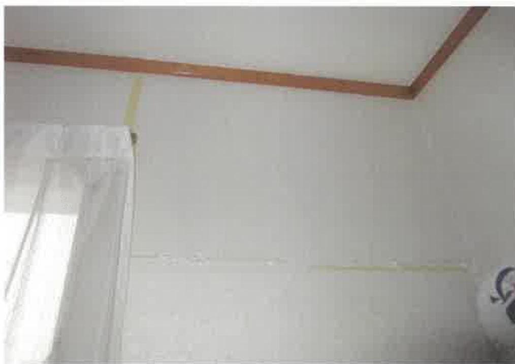
物件1:2階洋室の内壁クロスのひびの状況
