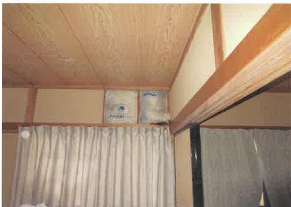
物件1:2階和室2の内壁の損傷状況
