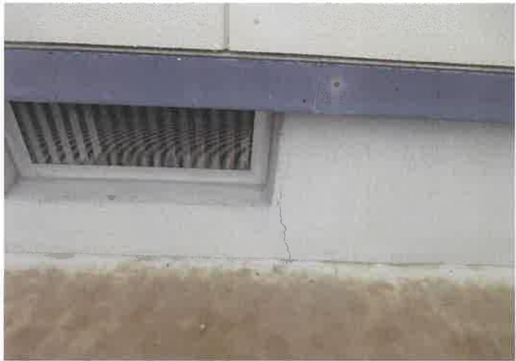
物件1:土台部分のひびの状況
