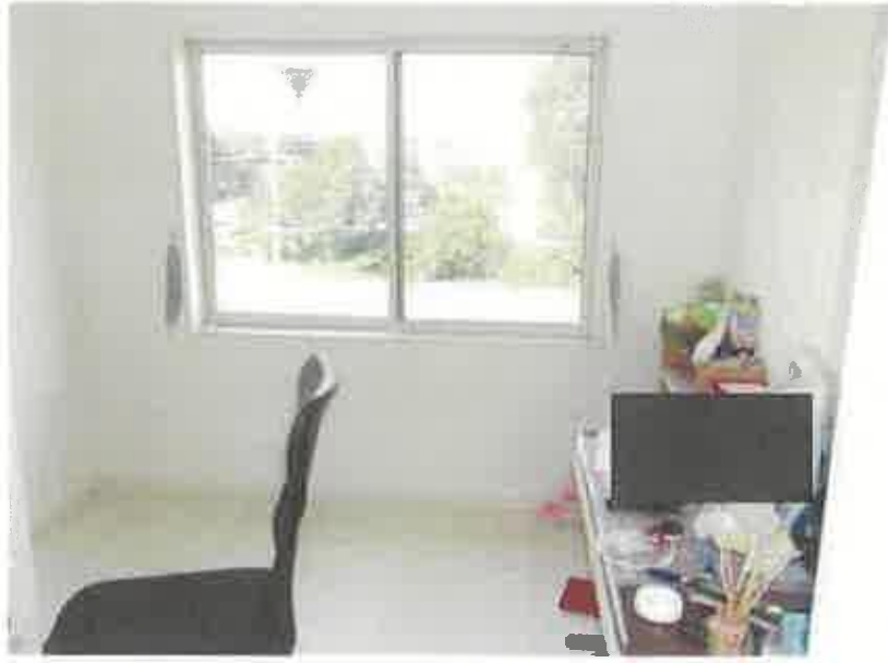
物件2:3階北西側洋室の状況
