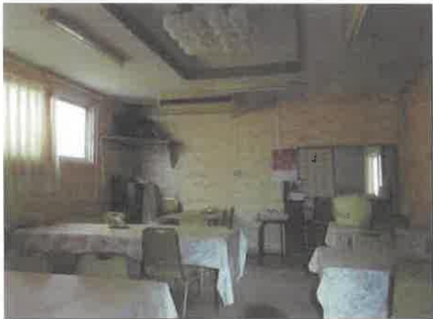
物件8・9:1階 食堂の状況
