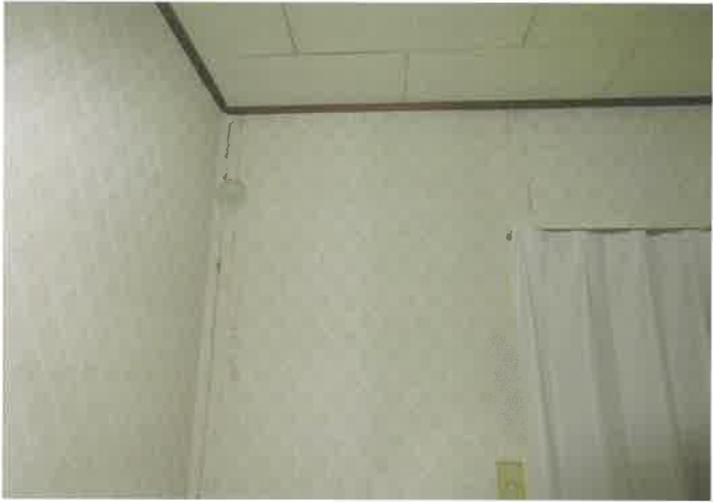
物件2:2階洋室の内壁クロスのひび等の状況
