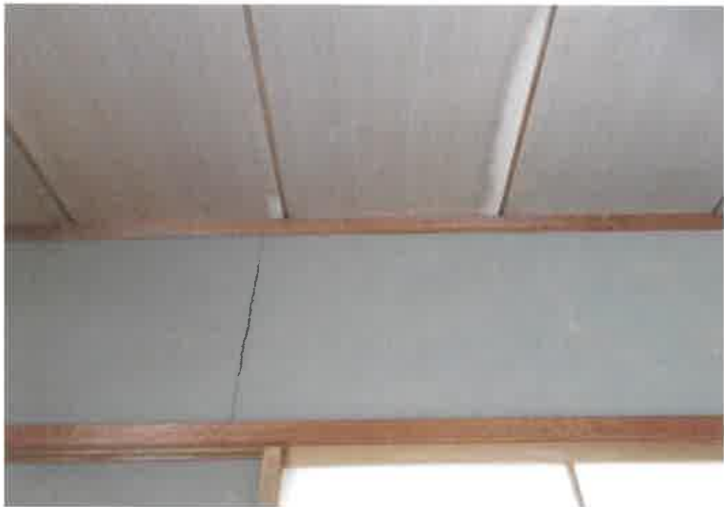
物件2:2階和室の内壁のひびや天井板の剥がれの状況
