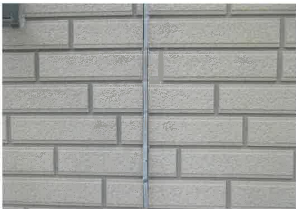
物件2:目地の損傷等の状況
