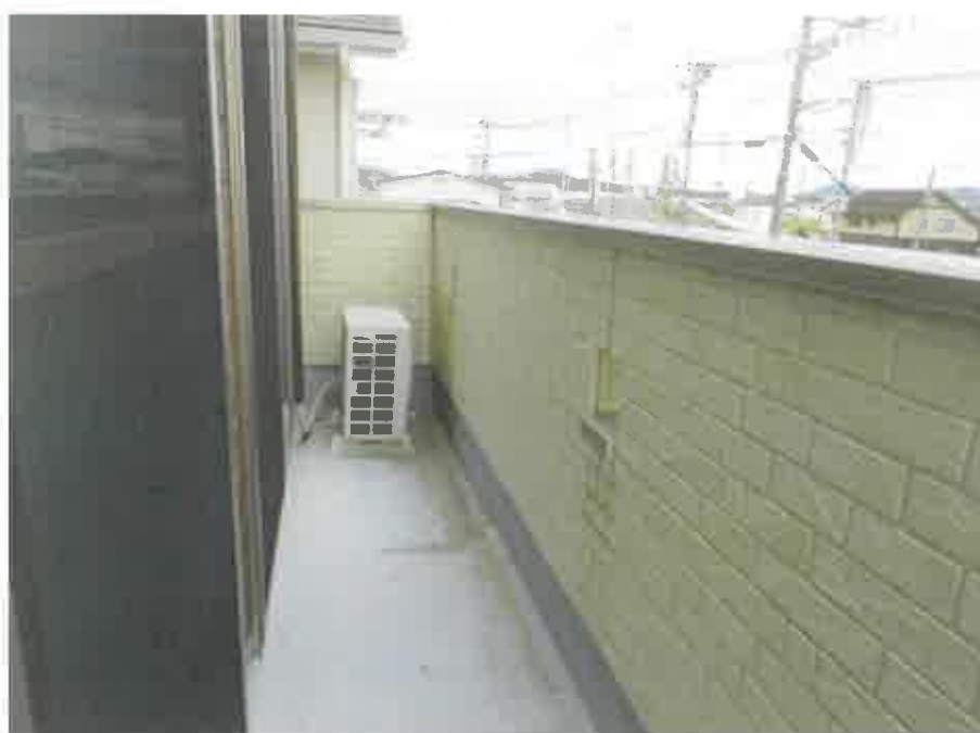
物件4:2階バルコニーの状況
