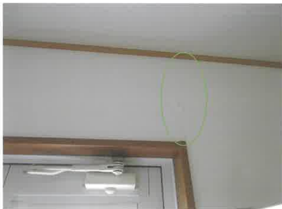
物件2:1階勝手口上部壁クロスの亀裂
