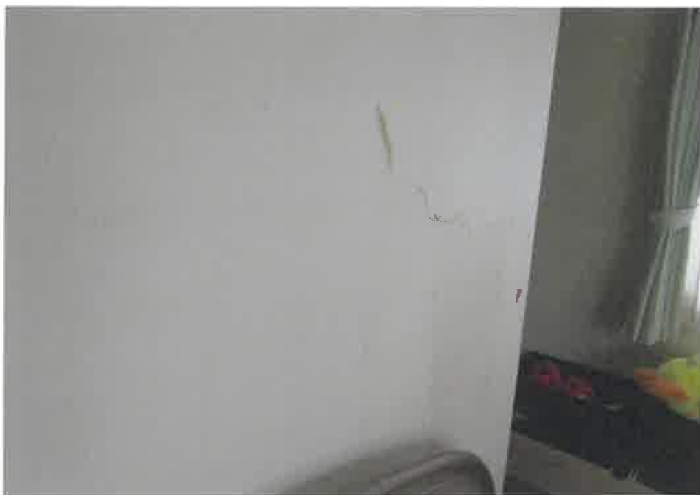
物件2:2階東側洋室の内壁クロスの剥がれの状況
