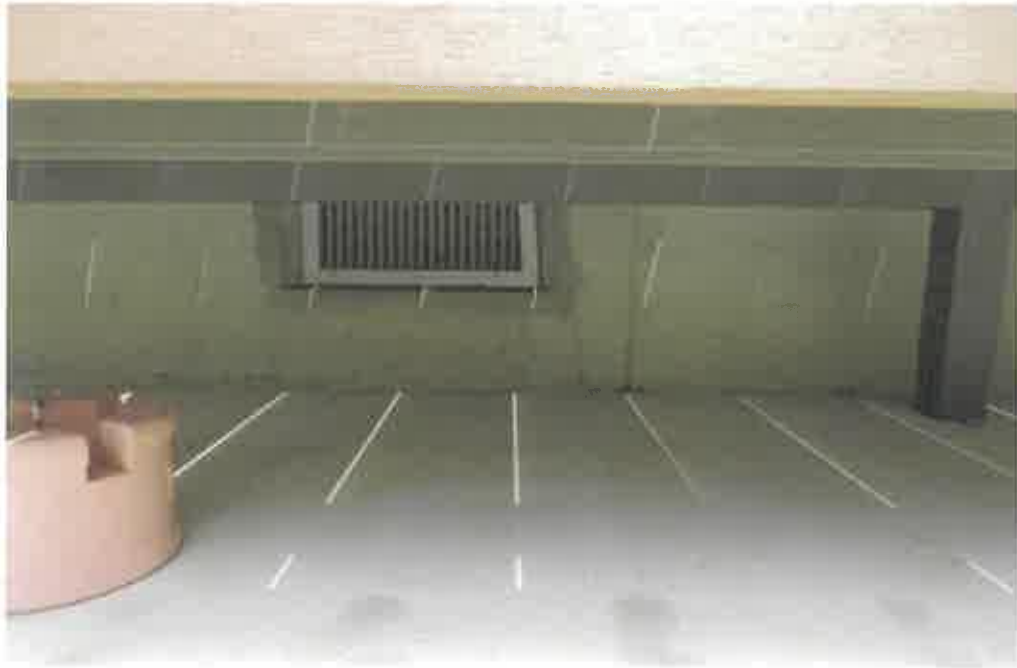
物件2:土台部分のひびの状況
