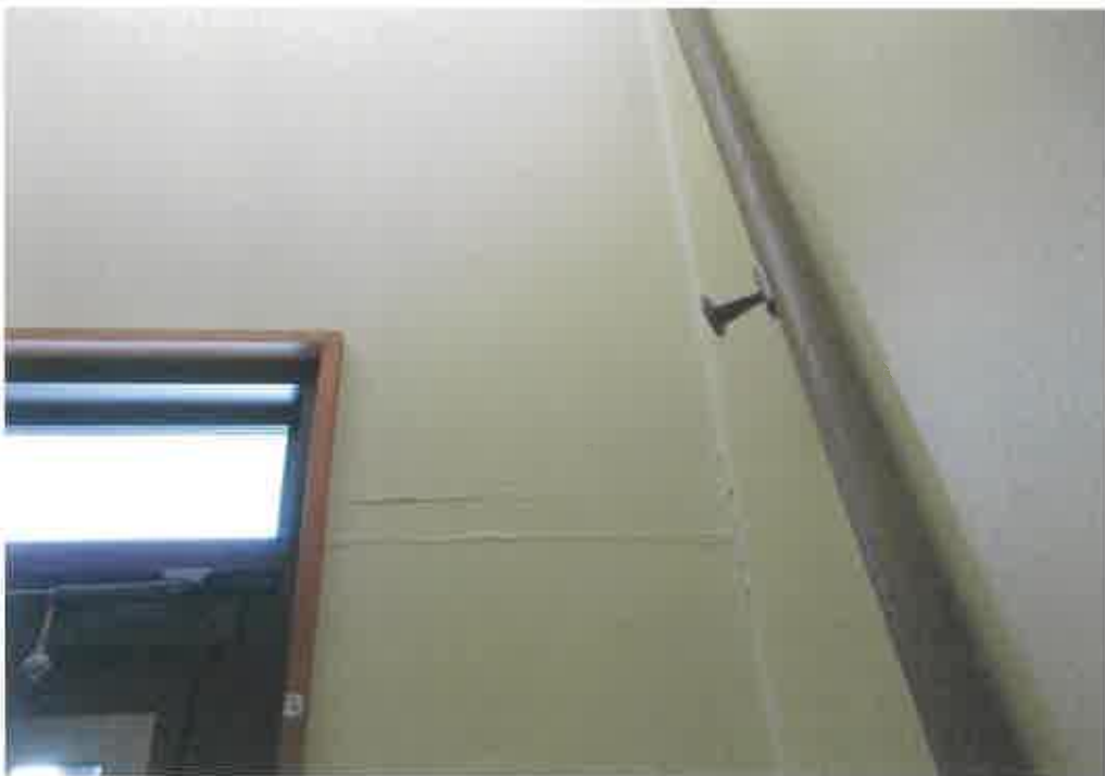
物件2:玄関側内壁クロスのひび等の状況
