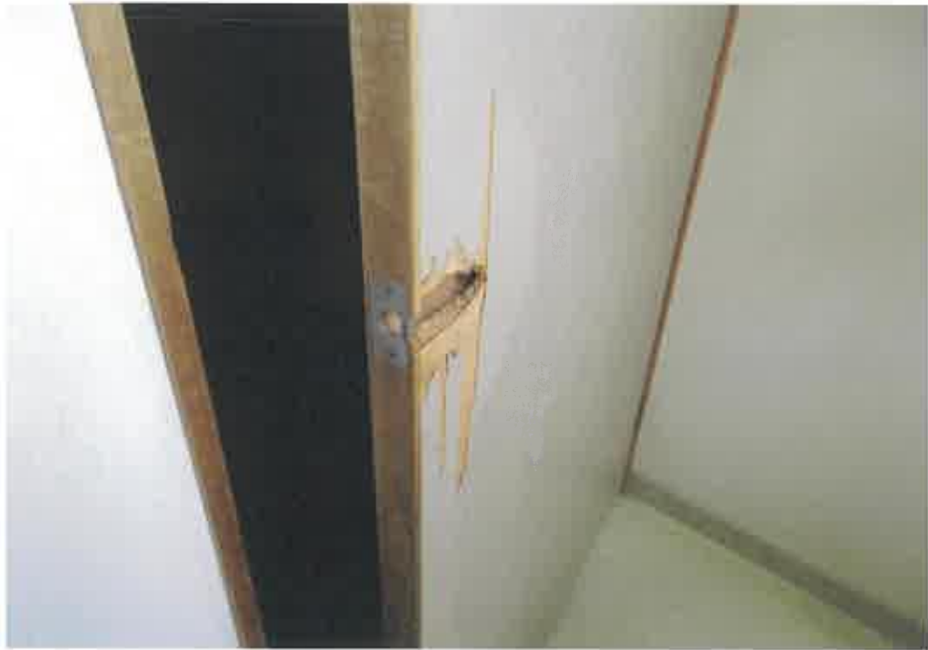
物件2:1階洗面室のドアの損傷状況
