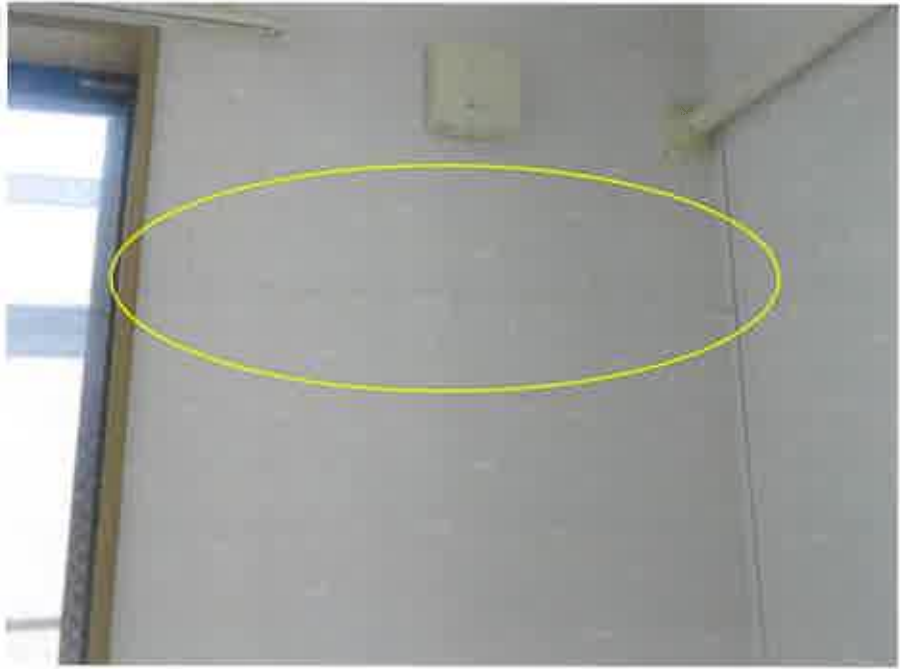
物件1:2階南西側洋室壁面の亀裂
