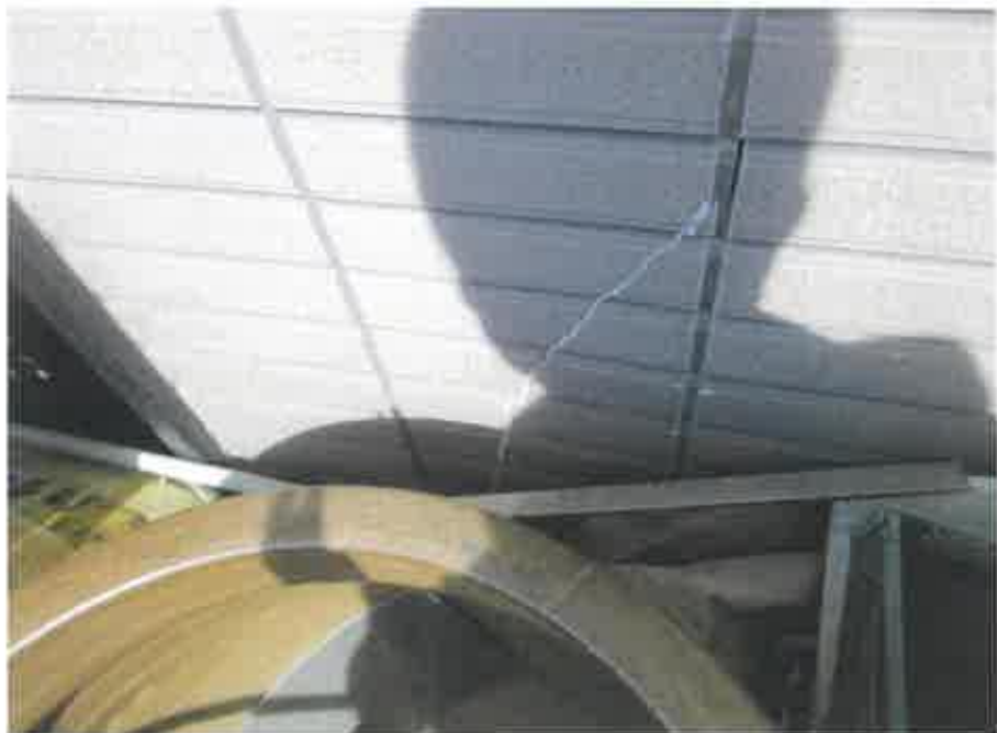
物件1:1階部分の西側外壁の亀裂
