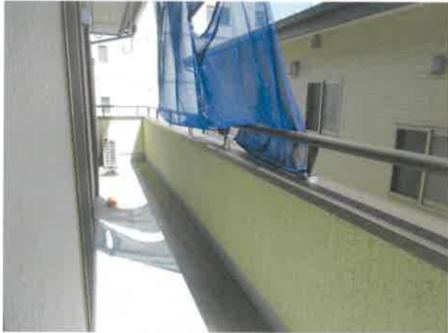
物件1:2階ベランダの状況
