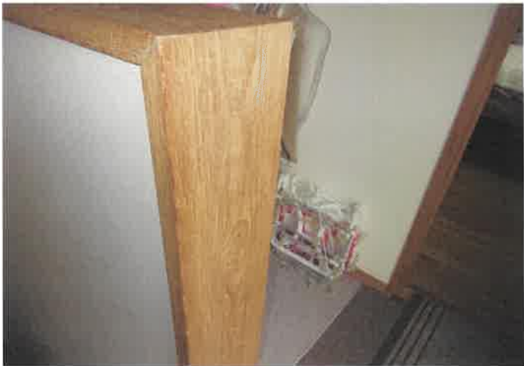
物件2:2階階段の手すりにある猫の引っ掻き傷の状況
