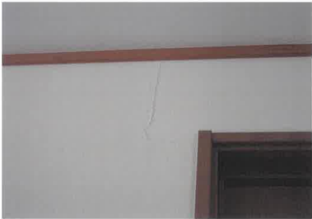
物件2:1階リビングの内壁クロスのひびの状況
