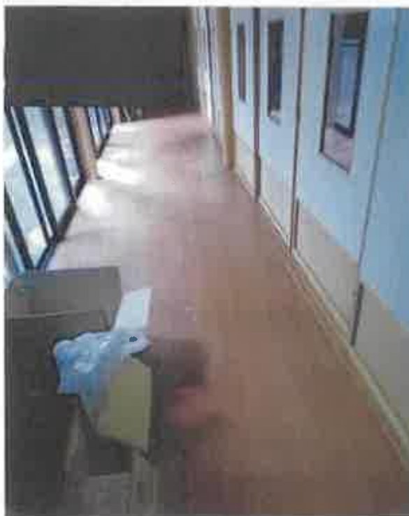
物件2:広縁部分の床の褪色の状況
