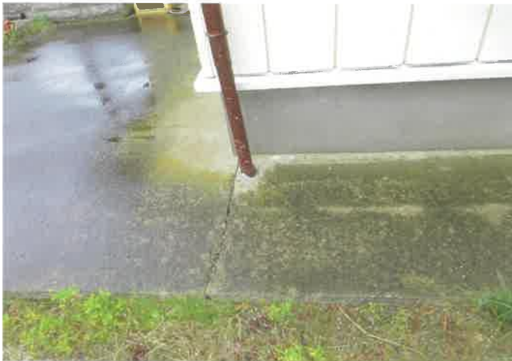
物件2主である建物:犬走部分のひびの状況
