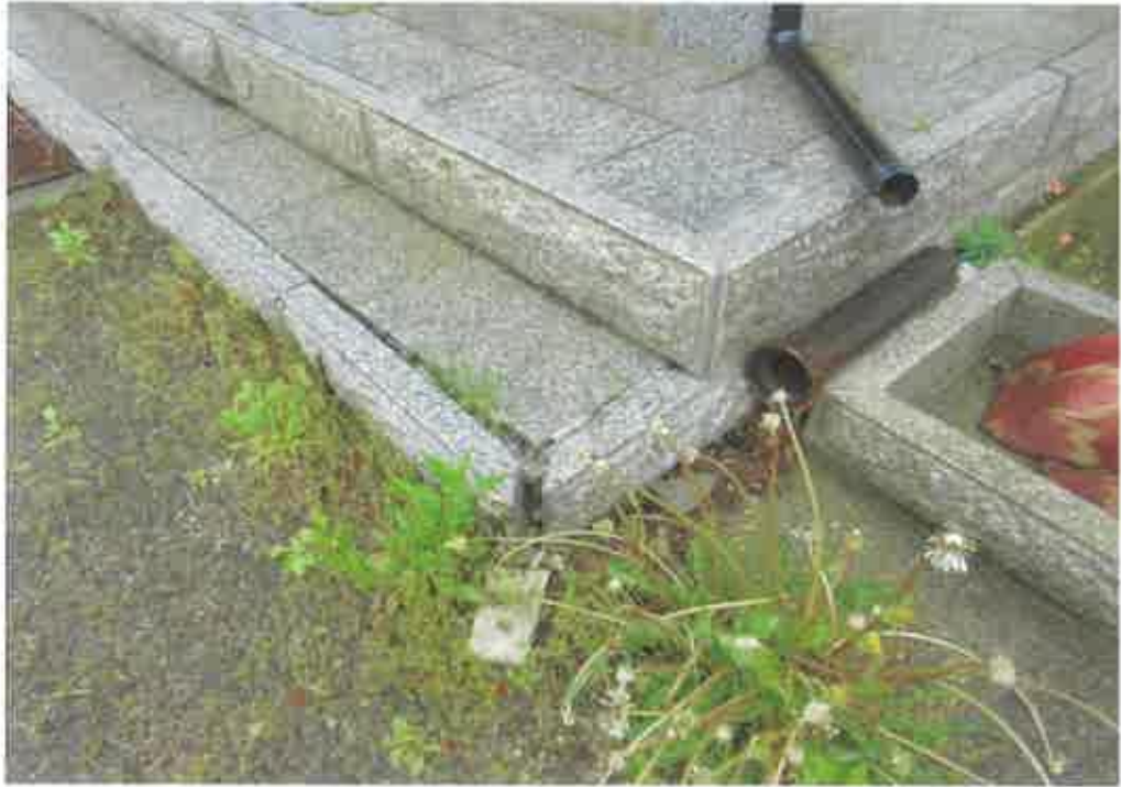
物件2主である建物:玄関前階段アプローチの石材の損傷状況
