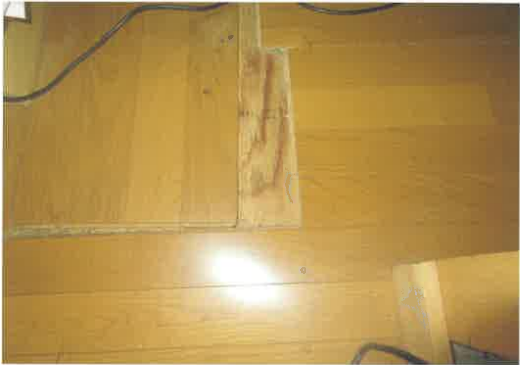
物件1:事務所2の床の損傷状況
