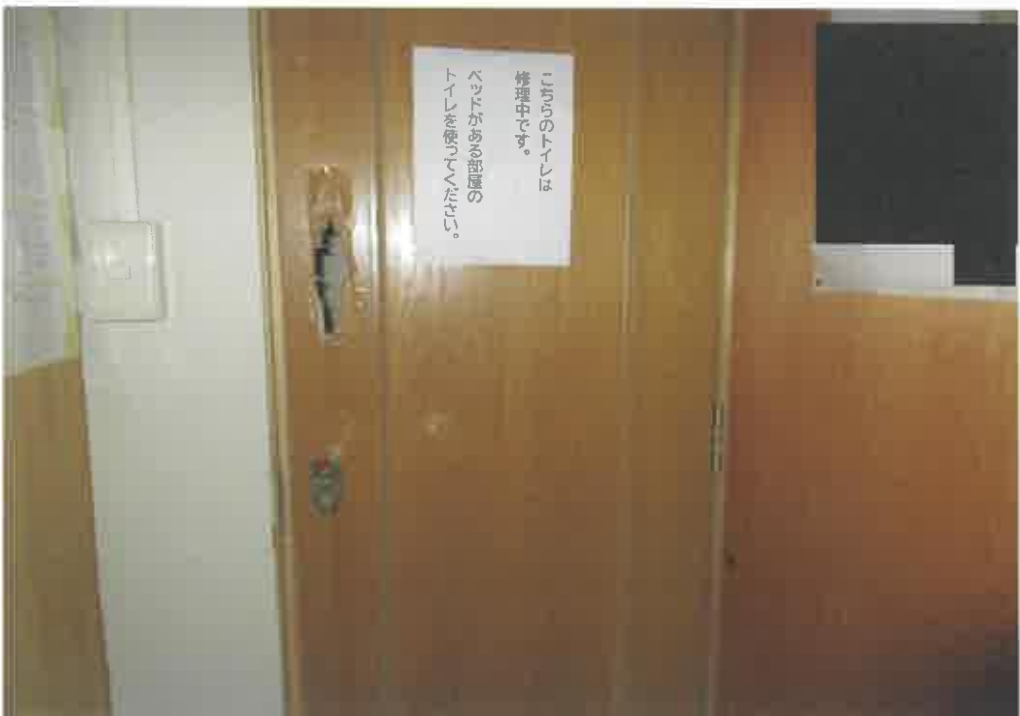
物件1:事務所1側のトイレのドアの損傷等の状況
