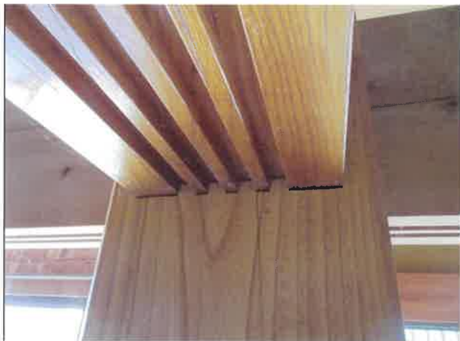
物件2:1階和室2、3の柱と梁の隙間
