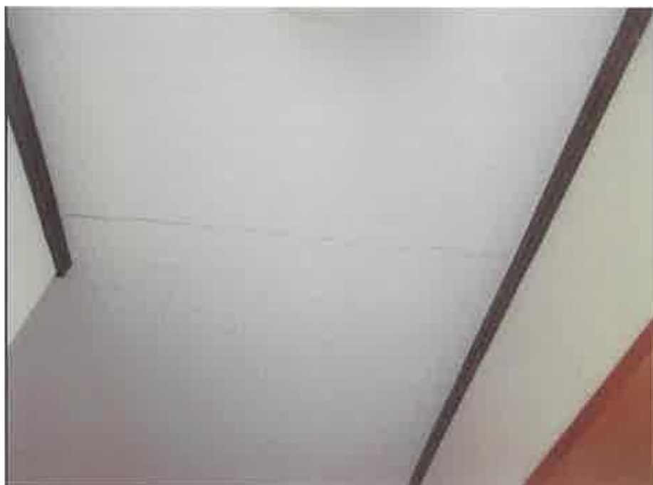
物件2:2階廊下の天井と壁の亀裂
