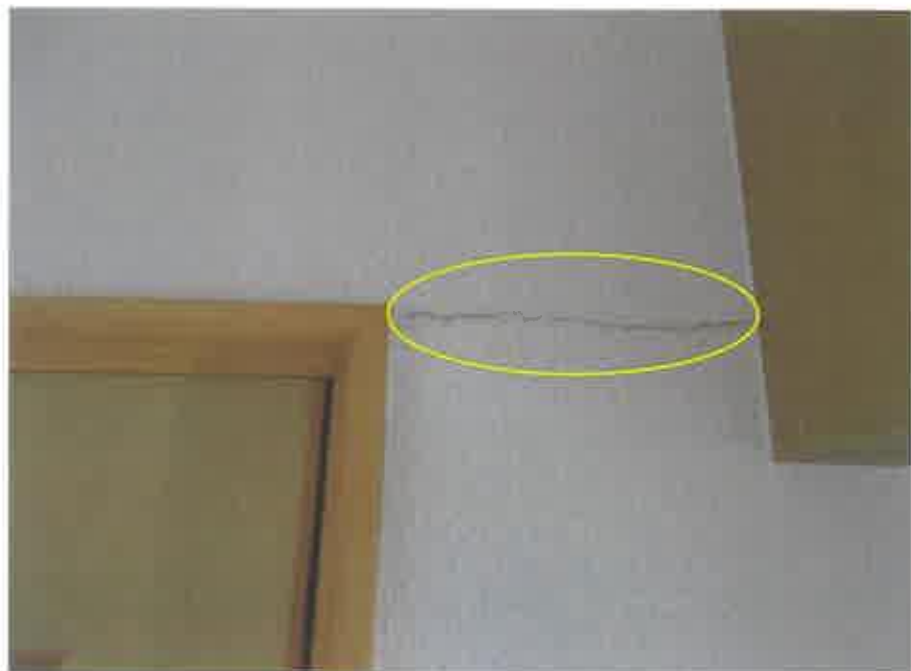
物件4:主である建物 1階玄関壁面の亀裂 No. 10
