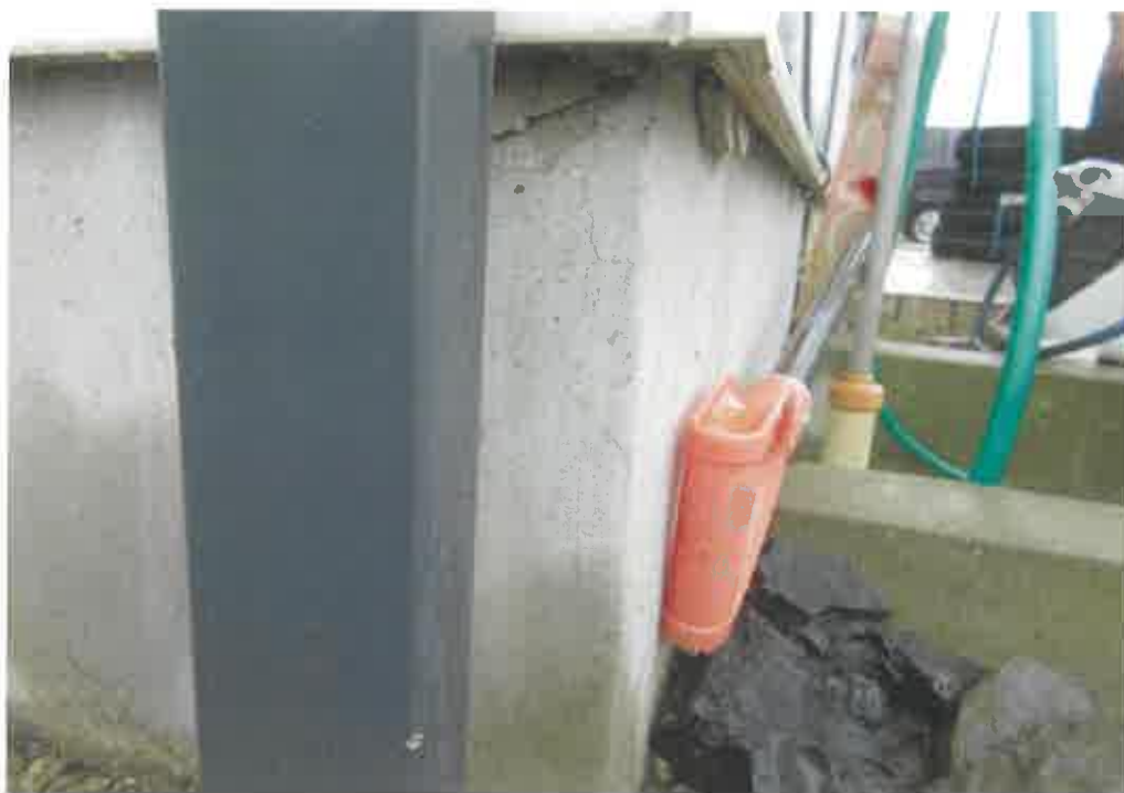
物件3:土台のひび等の状況
