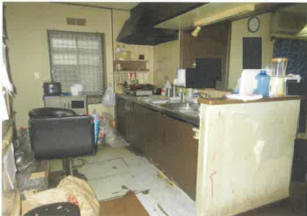
物件3:1階台所の状況
