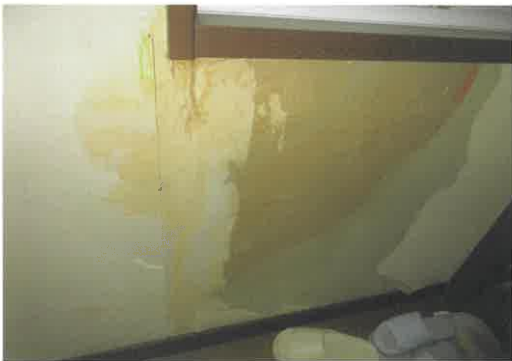
物件3:2階廊下の内壁クロスの損傷等の状況
