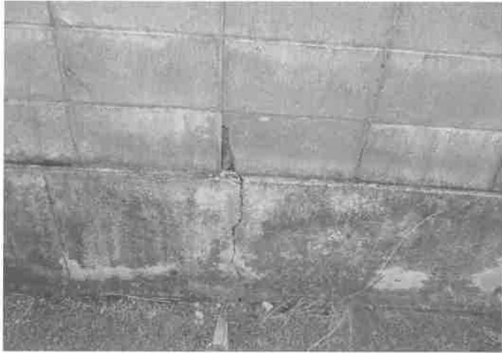
北西側ブロック塀のひび等の状況
