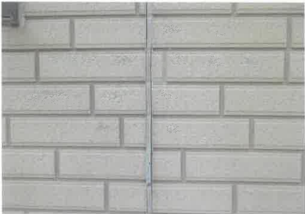
物件2:目地の損傷等の状況
