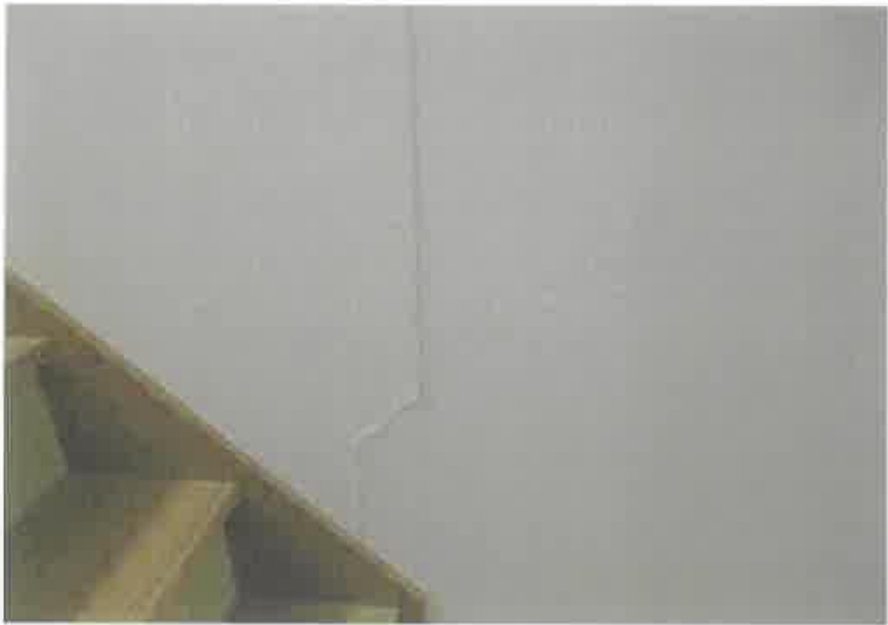
物件2:階段の内壁クロスのひびの状況
