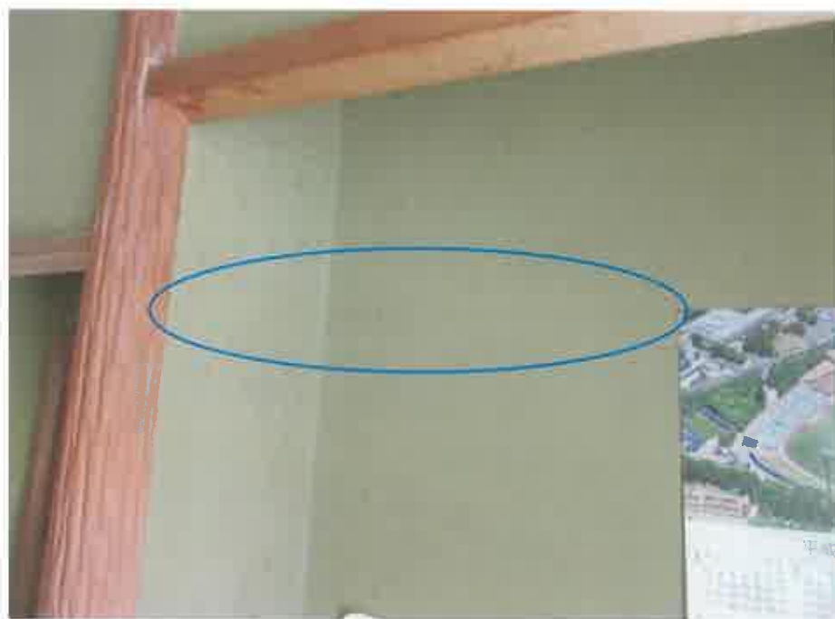
物件2:和室3床の間の壁の亀裂
