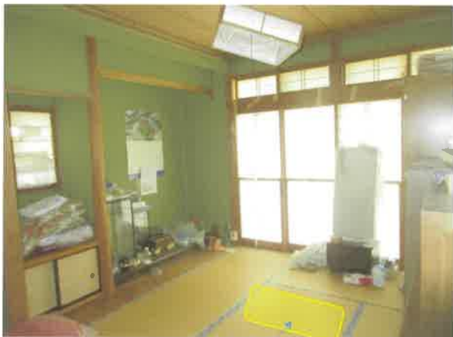
床が抜けそうな箇所 物件2:和室3の状況
