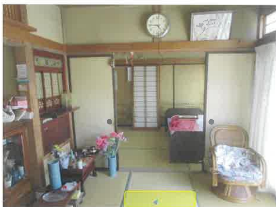
床が抜けそうな箇所
