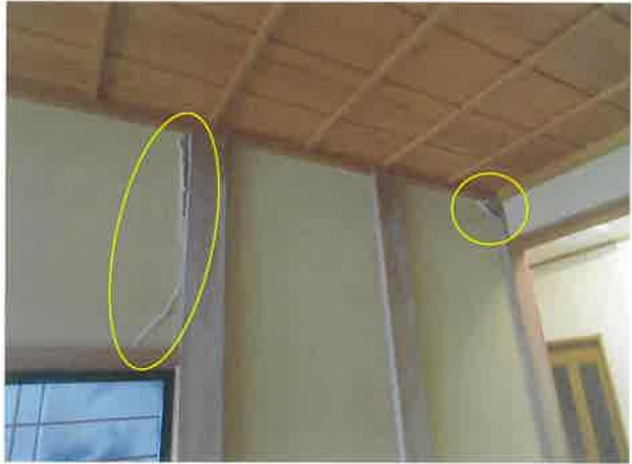
物件3:玄関ホールの壁面の亀裂
