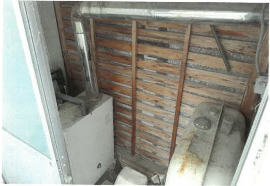
物件2主である建物:ボイラ室の状況
