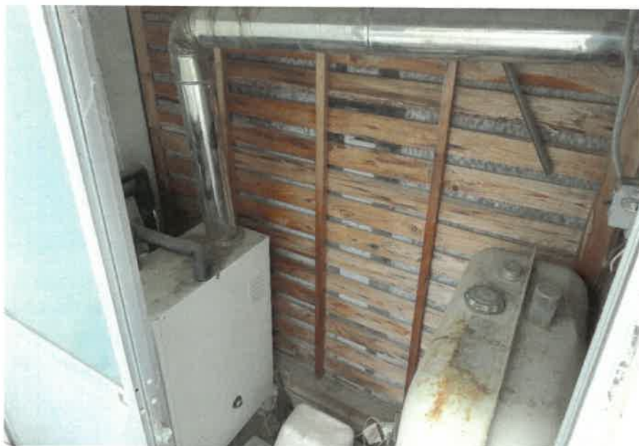
物件2主である建物:ボイラ室の状況
