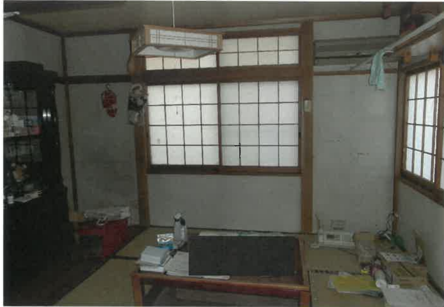
物件2:1階台所西側和室(掘ごたつ)の状況
