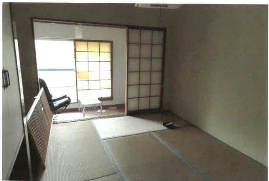
物件23主である建物:2階和室2号の状況
