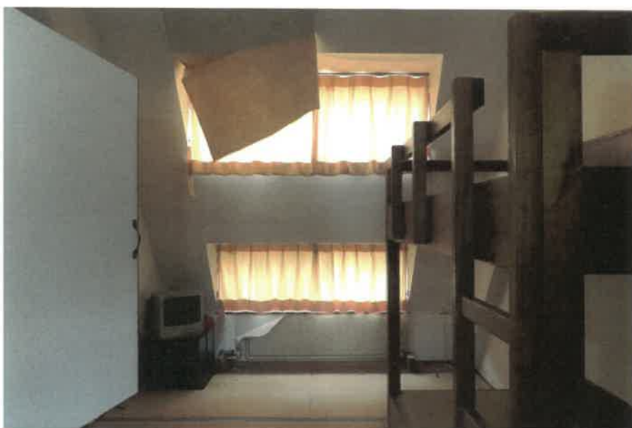
物件23主である建物:2階23号室の状況
