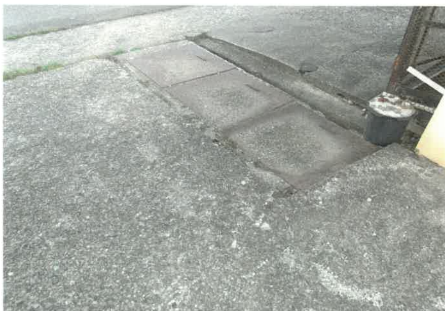
物件1:オイルピットの状況
