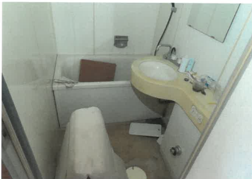
物件4:2階和室(20)のユニットバスの状況
