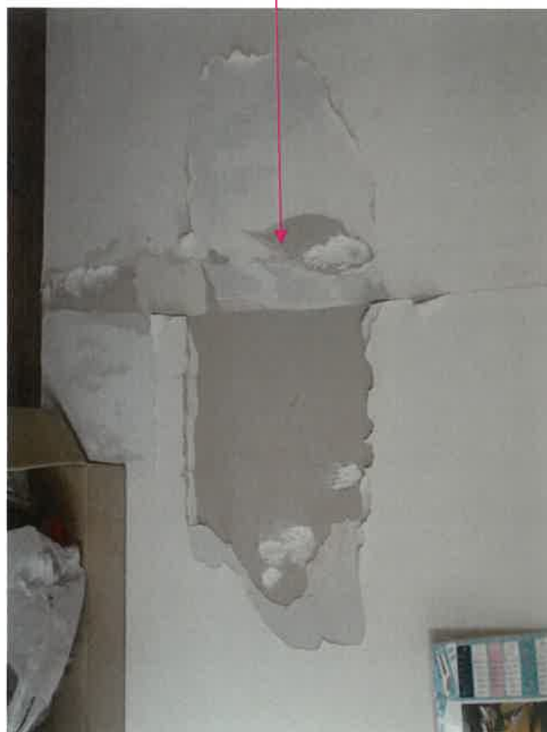
物件2:2階洋室の壁の剥がれ
