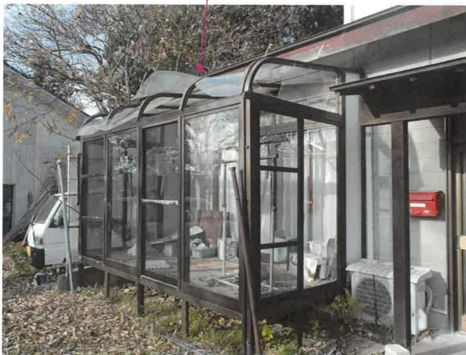
物件2:サンルームの屋根の破損
