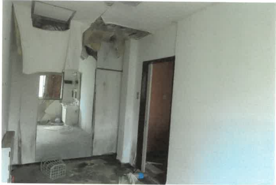
物件23主である建物:1階女子浴室前脱衣室の状況
