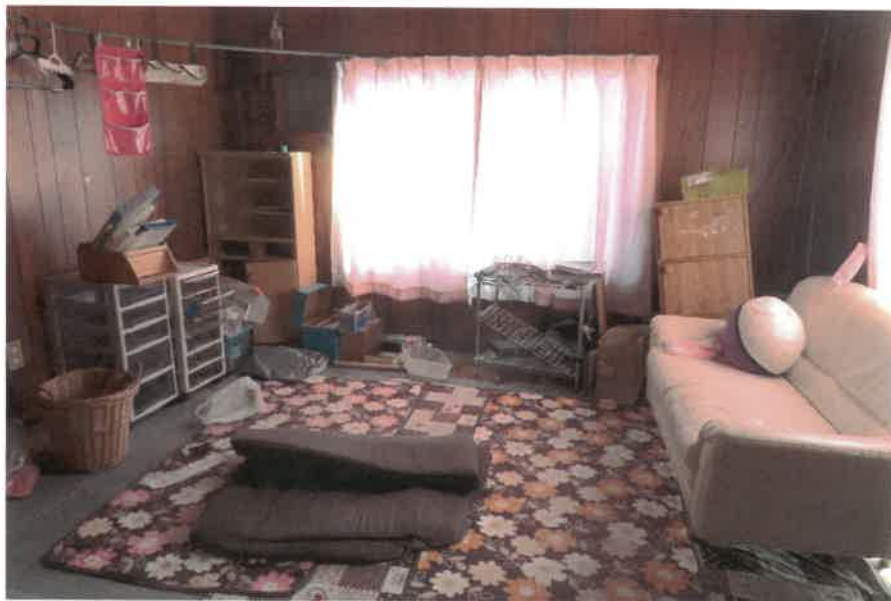
物件2主である建物: 1階洋室の状況
