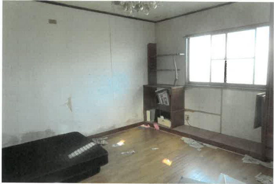
物件2主である建物:2階洋室の状況
