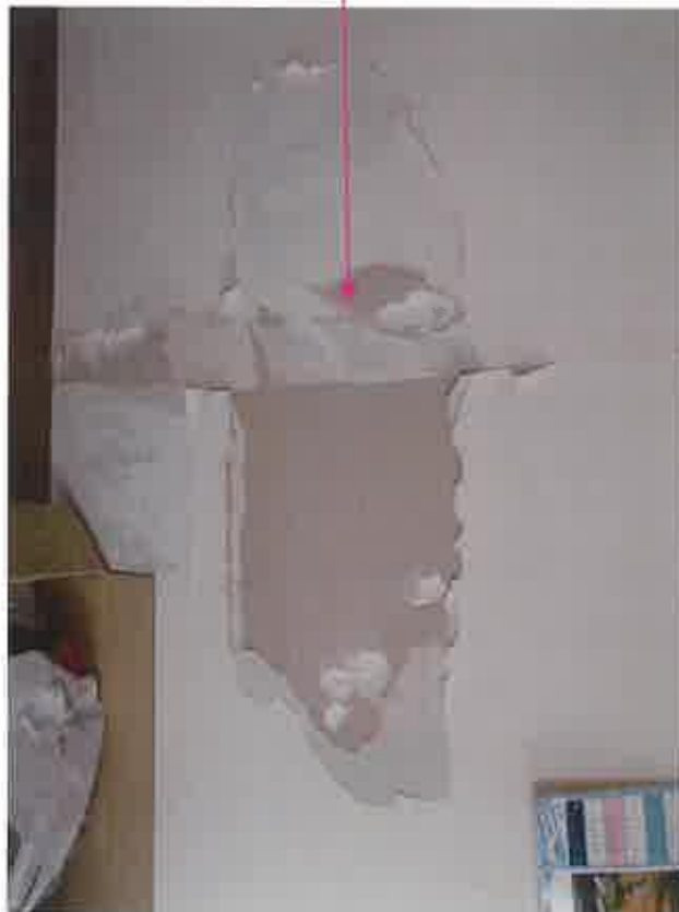
物件2:2階洋室の壁の剥がれ
