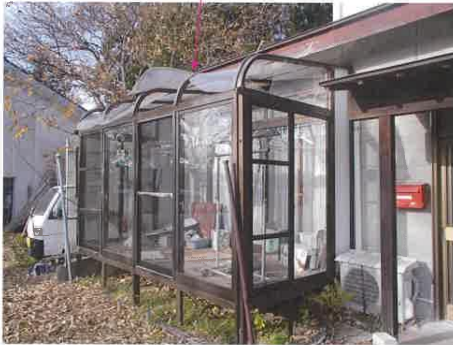
物件2: サンプルームの屋根の破損
