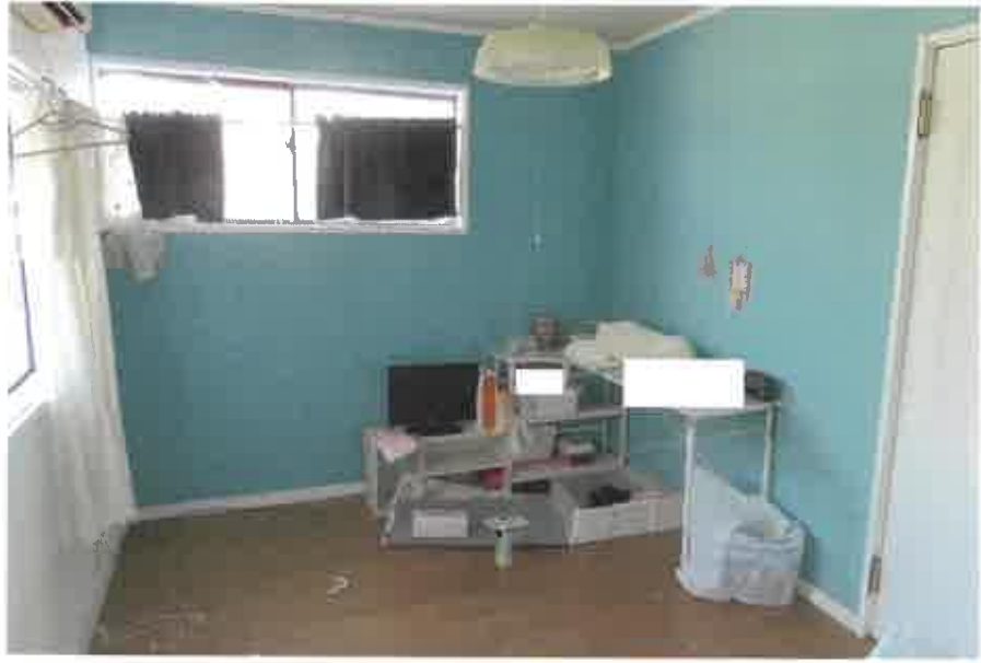
物件2:2階北側洋室の状況
