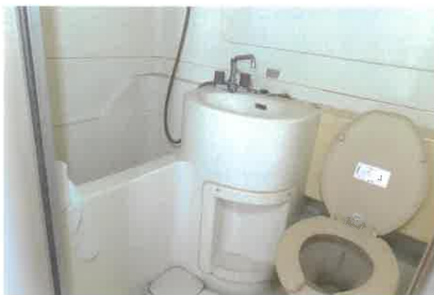
物件2店舗部分:2階浴室の状況
