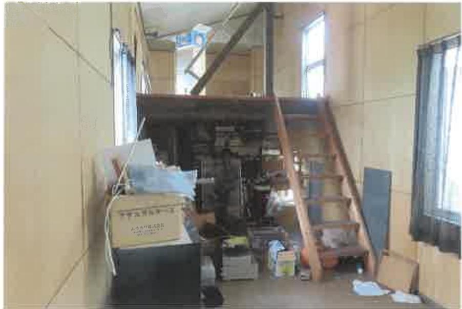
物件2店舗部分:2階洋室1の状況
