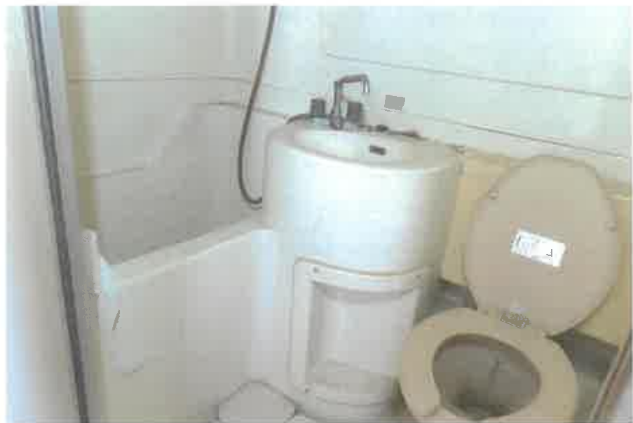
物件2店舗部分:2階浴室の状況
