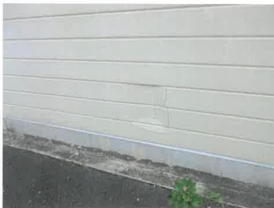
物件2:外壁の陥没箇所
