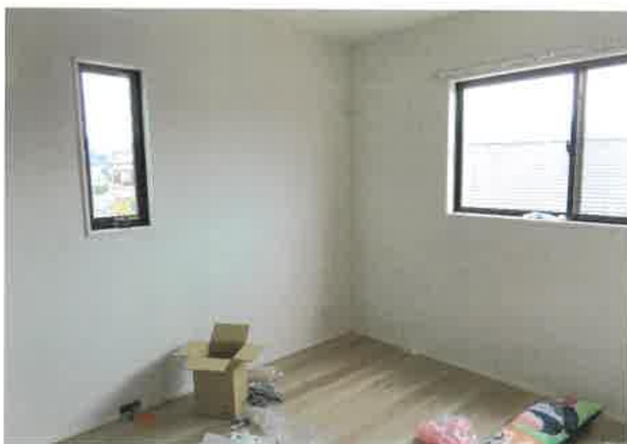
物件2:2階北西側洋室の状況
