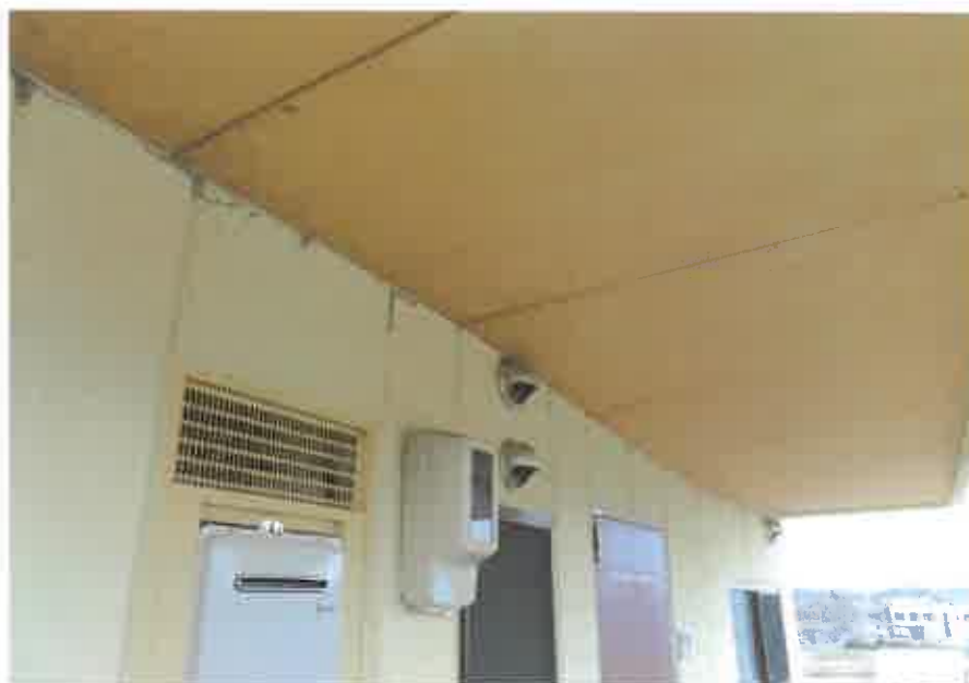
物件3主である建物:4階通路(416号室付近)の天井の状況
