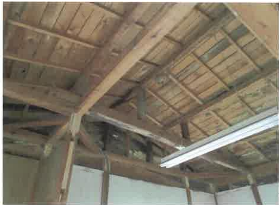
物件9:作業場の天井の状況
