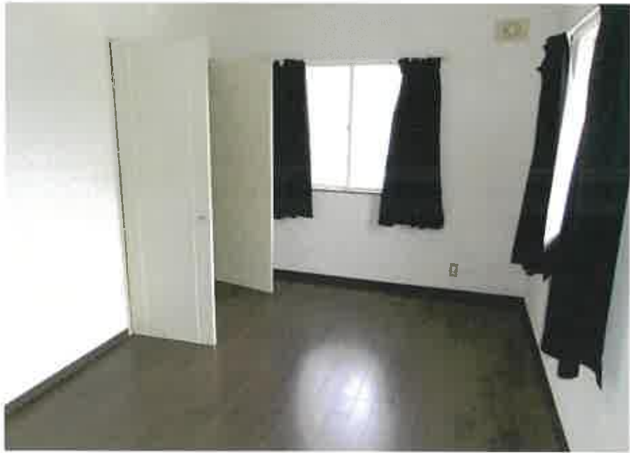
物件2:2階北東側洋室の状況
