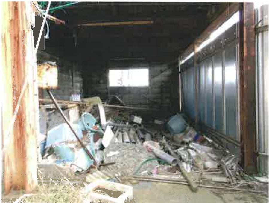
物件2附属建物符号1:1階機械室の状況
