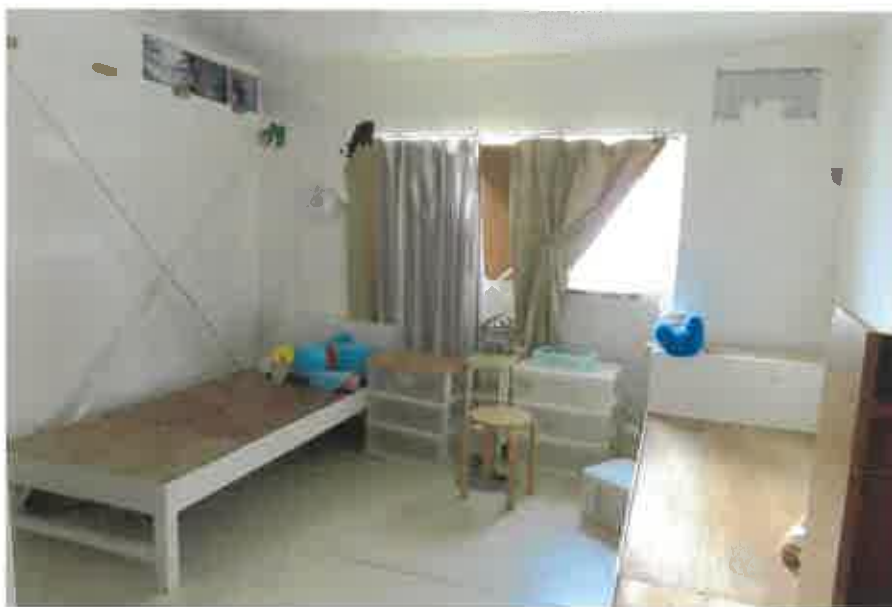
物件2主である建物:2階寄宿舍部屋③の状況
