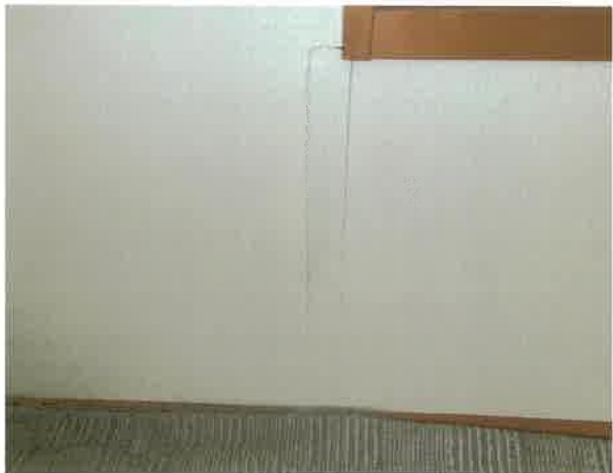
物件1:1階和室西側壁の状況
