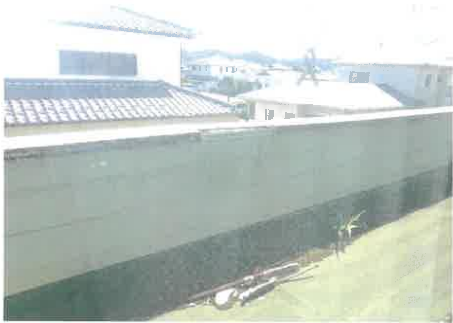
物件1:2階ベランダの状況
