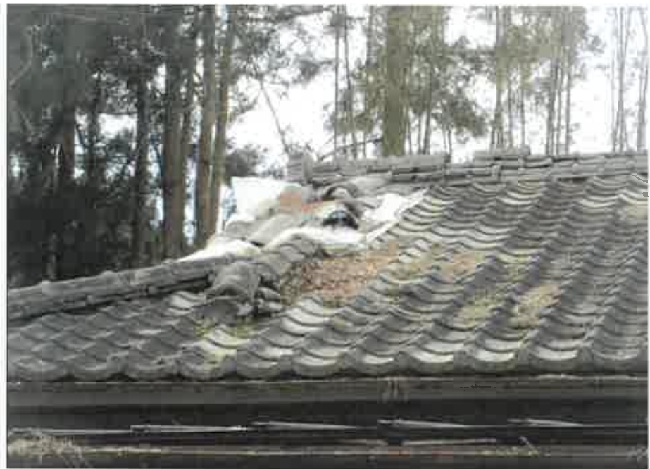
物件3:屋根瓦の破損した状況
