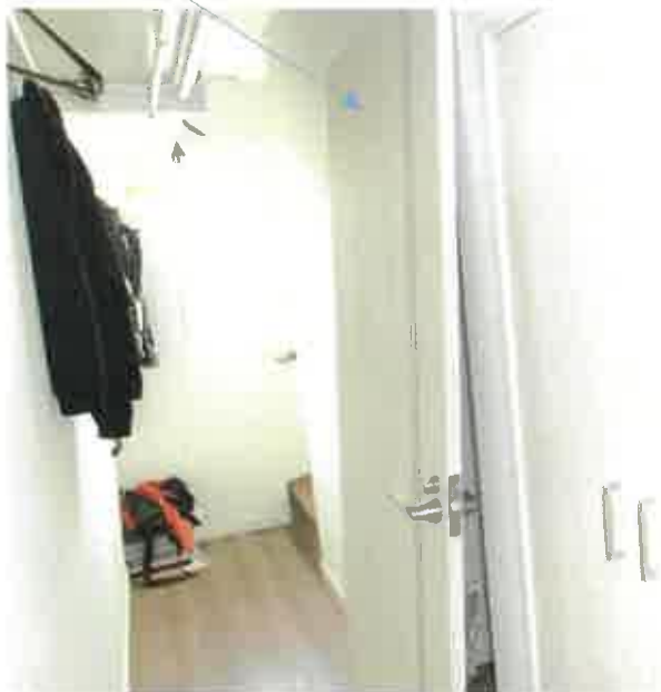
立て掛けられた脱衣室入口ドア
