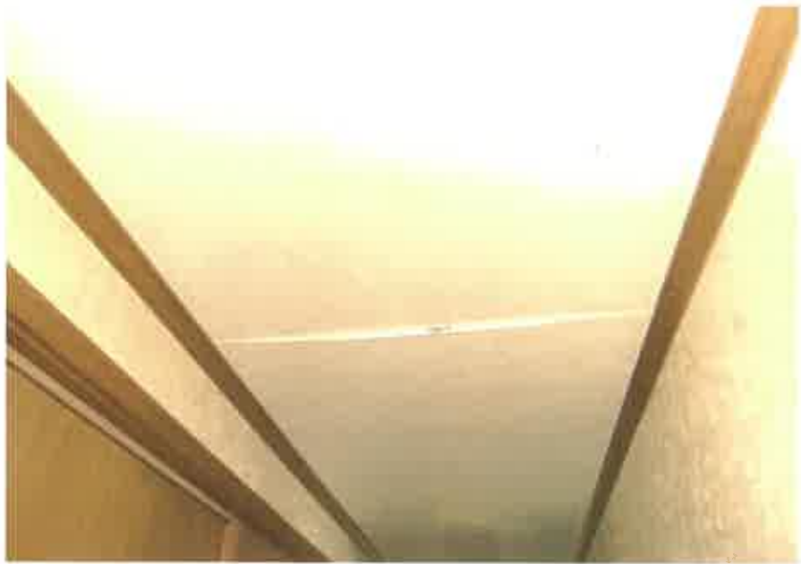
物件1:1階東側和室の北隣廊下天井部分の状況
